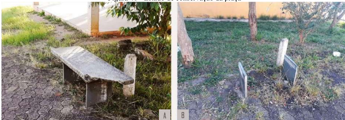
(A) Banco rompido (B) Banco sem assento. Fonte: Autora, 2021.
