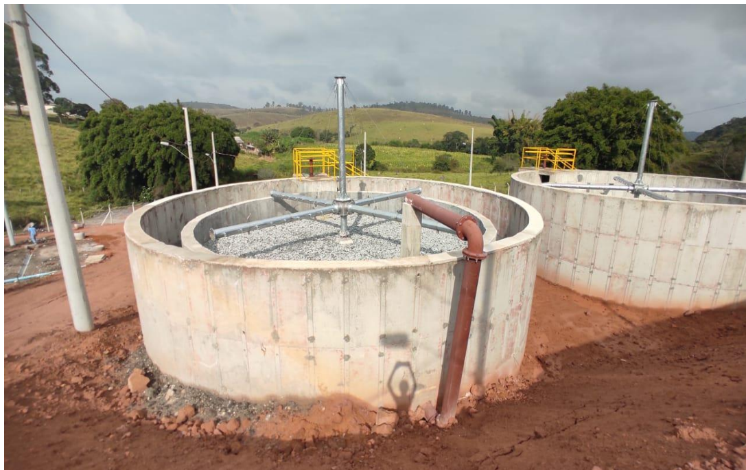
Figura 13 – Filtro biológico percolador
