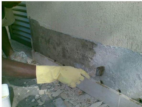
Figura 11 – Impermeabilização do rodapé
