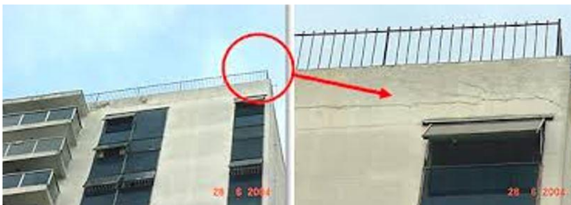
Figura 12 – Patologia em pingadeira
