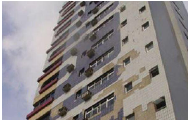
Figura 14 – Destacamento do revestimento cerâmico de fachada
