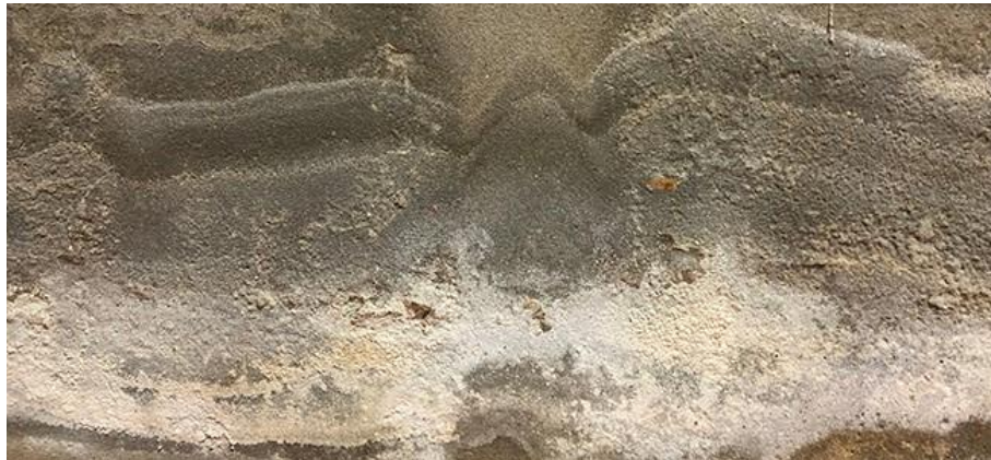
Figura 15 – Ocorrência de eflorescência de coloração branca na superfície do concreto
