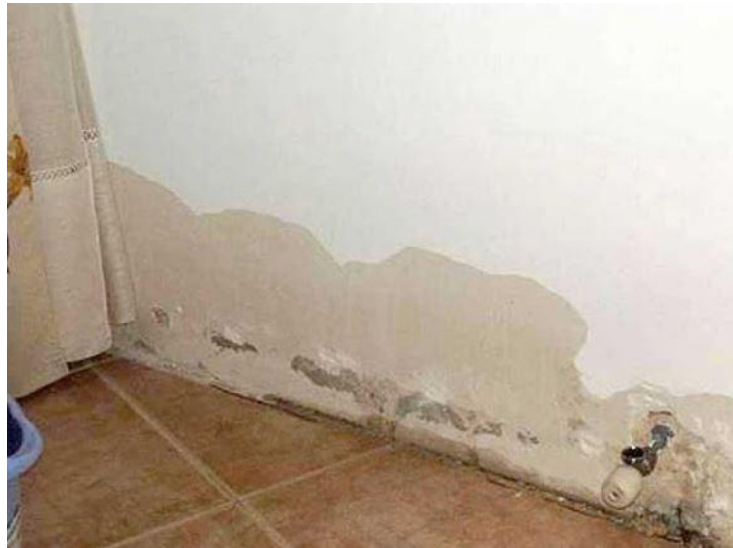
Figura 10 – Patologias provocadas pela má impermeabilização da parede
