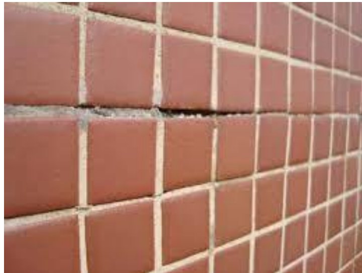
Figura 13 – Deterioração das juntas de dilatação
