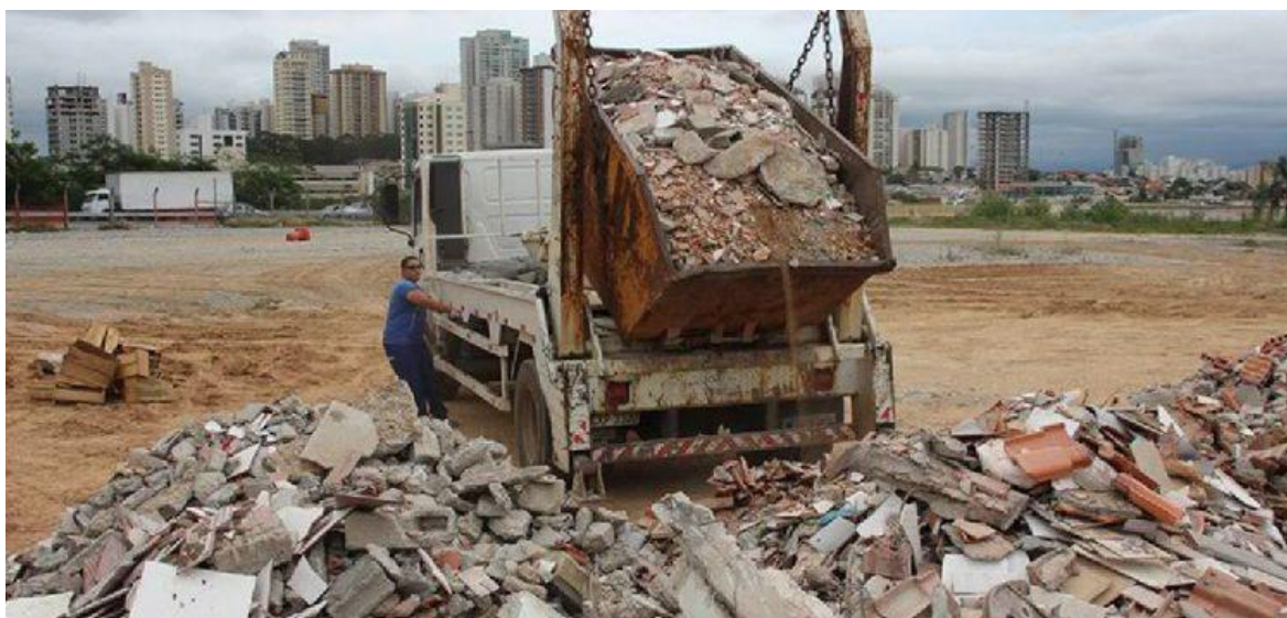
Figura 8 – Desperdício de materiais na construção civil.
