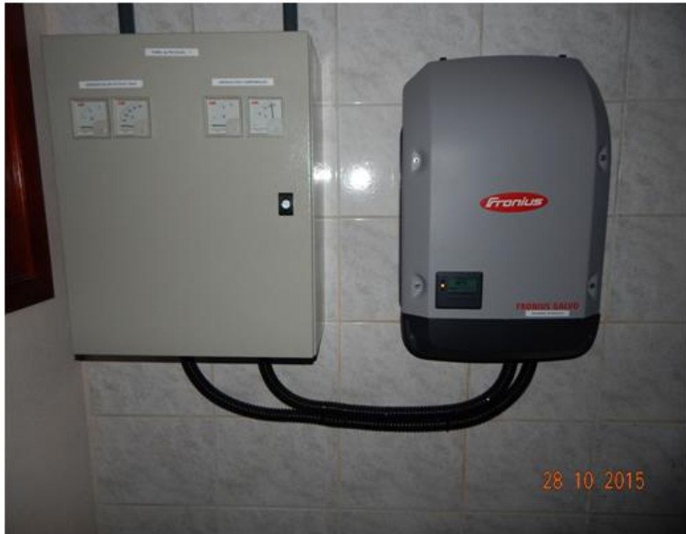
Figura 20 – Inversor da Usina Solar dos Lotte
