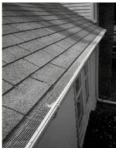
Figura 4 - Exemplo de tela horizontal, colocada junto à calha para reter poluentes.
