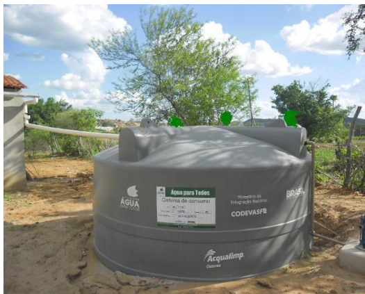
Figura 15 - Cisterna de polietileno.
