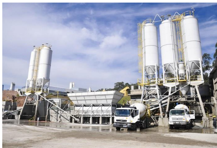
Figura 13 – Usina de concreto fixa
