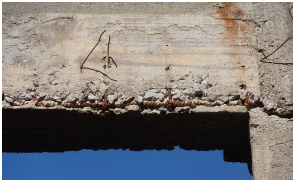
Figura 18 - Vazios no concreto
