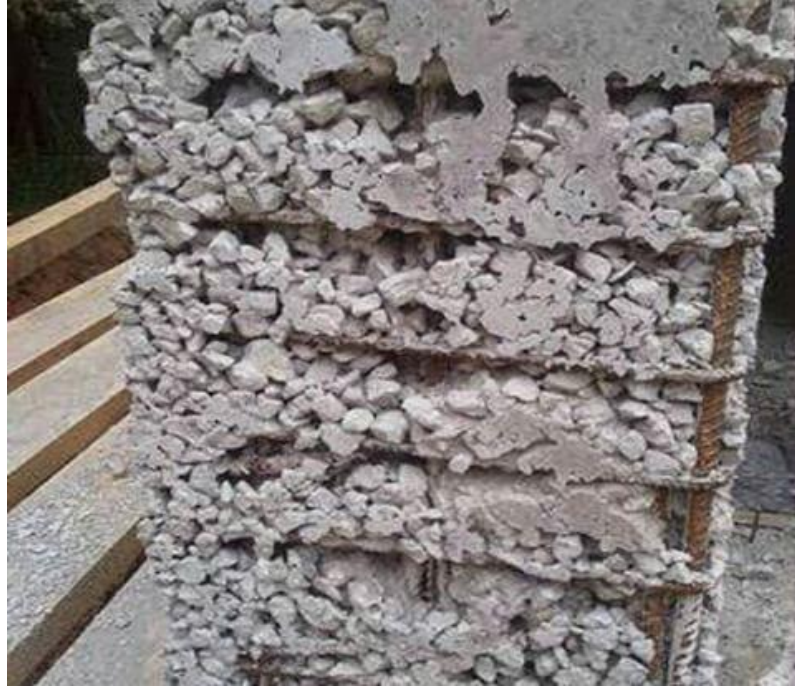
Figura 19 - Porosidade no concreto
