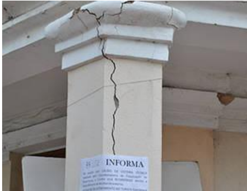
Figura 17 - Fissuras no concreto
