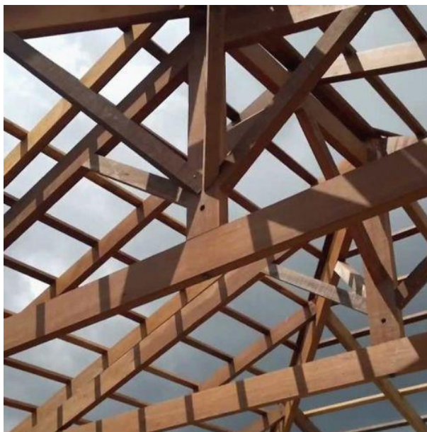
Figura 4–Ausência de Reforço nos Encaixes
