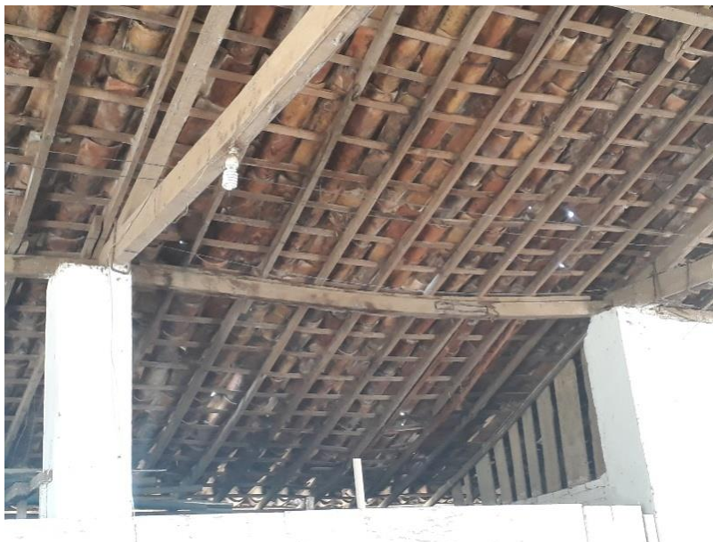
Figura 18 - Deformação Excessiva causada por Seção Insuficiente
