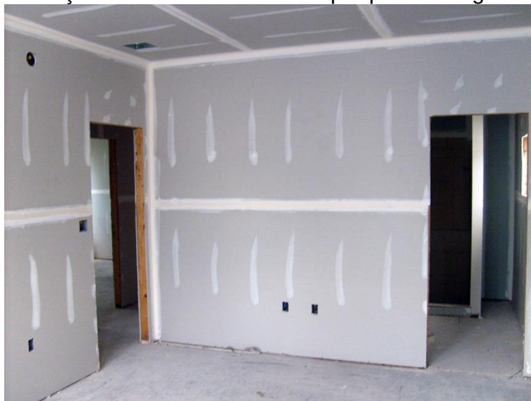
Figura 28 – Vedações internas constituídas por placas de gesso acartonado
