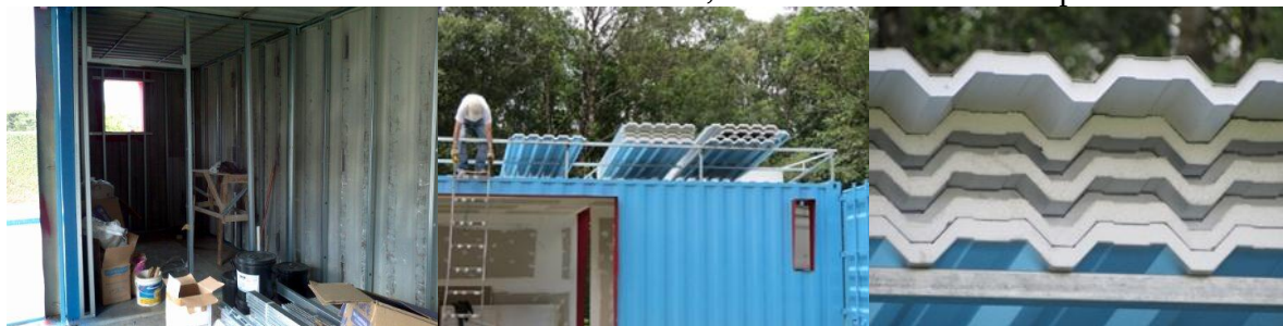
FIGURA 18 – Divisória do banheiro, telhado e telhas com isopor
