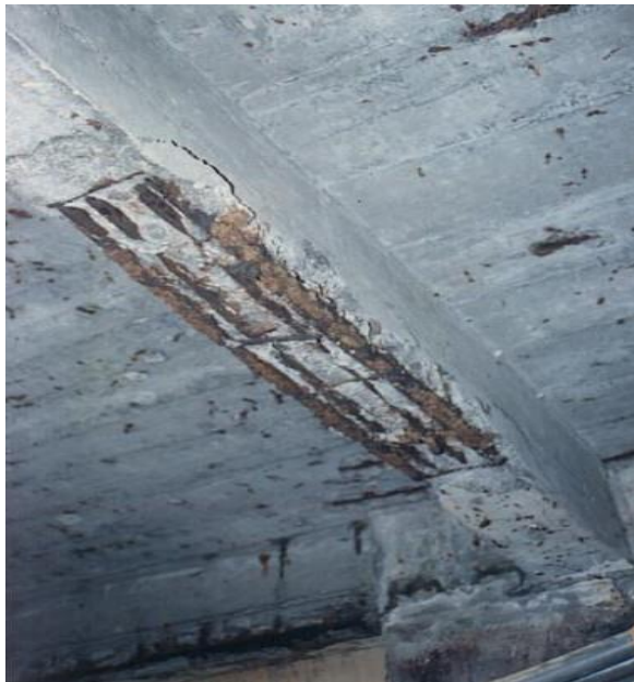
FIGURA 30 – Destacamento do concreto
