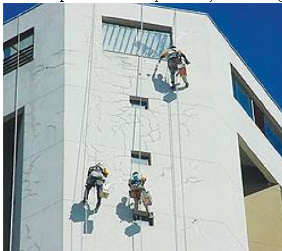
FIGURA 04 – Fissura mapeada causada por retração de secagem da argamassa
