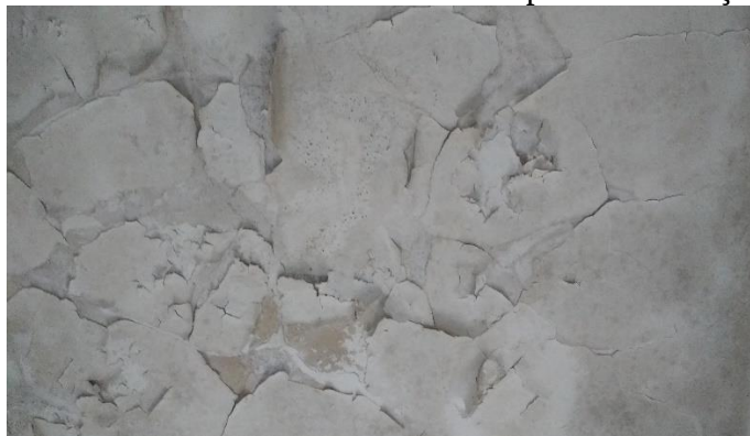
FIGURA 23 – Manchas ocasionadas pela condensação
