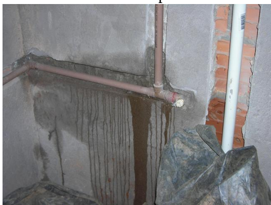
FIGURA 22 – Manchas trazidas por vazamentos hidráulicos
