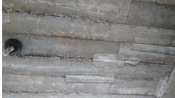
FIGURA 28 – Cobrimento insuficiente causando corrosão
