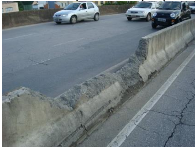
FIGURA 31 – Deterioração do concreto por ações mecânicas
