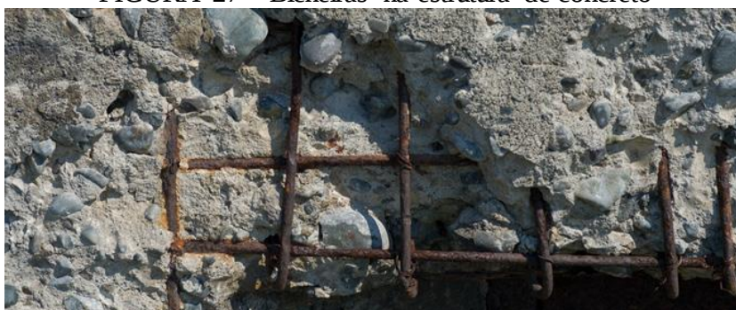
FIGURA 27 – Bicheiras na estrutura de concreto
