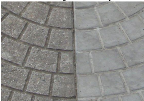
FIGURA 32 – Desgaste causado por abrasão
