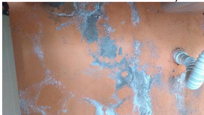
FIGURA 24 – Eflorescência na edificação
