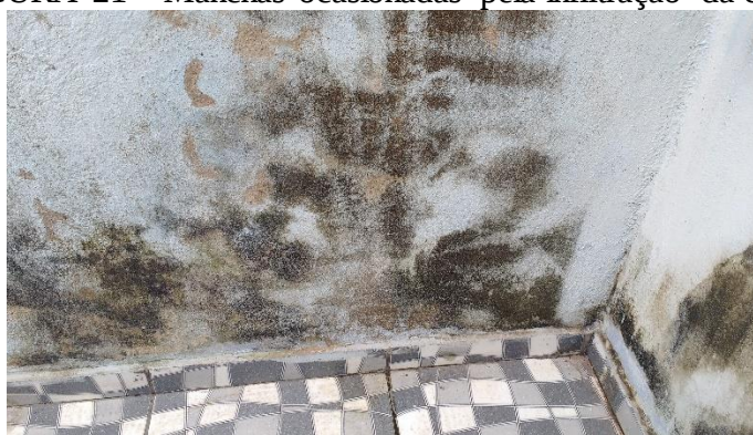
FIGURA 21 – Manchas ocasionadas pela infiltração da chuva
