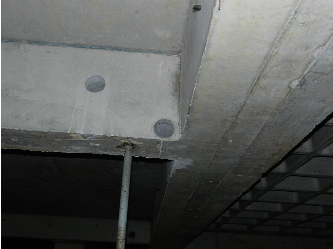
FIGURA 12 – Furo na viga sem o aval do profissional responsável
