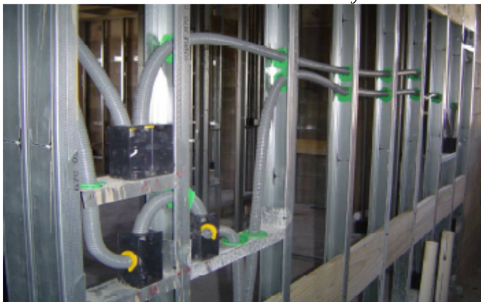
FIGURA 05 – Eletrodutos na estrutura drywall
