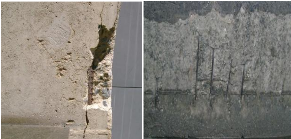
FIGURA 6 – Concreto visivelmente corroído, deixando a armadura exposta
