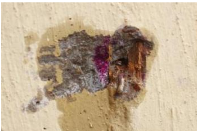
FIGURA 8 – Carbonatação do concreto
