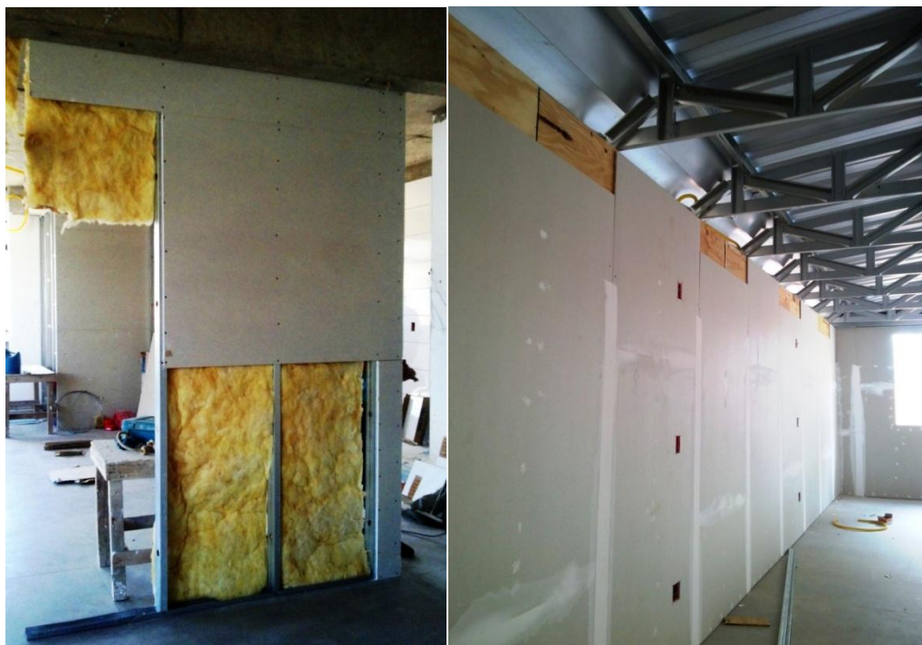
Figura 6 - Divisórias em Gesso Acartonado
