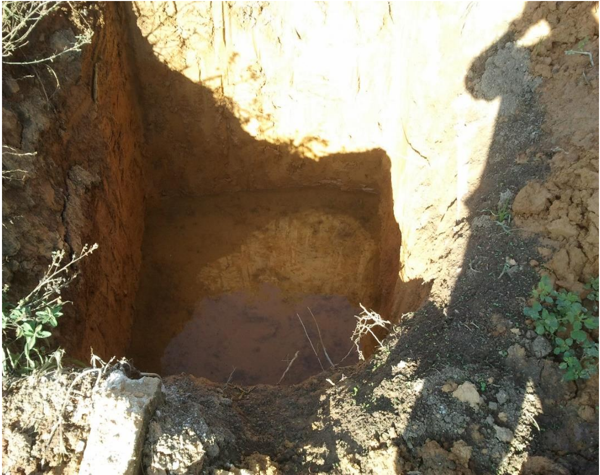
FIGURA 11 Valas de fundação com água a um metro de profundidade
