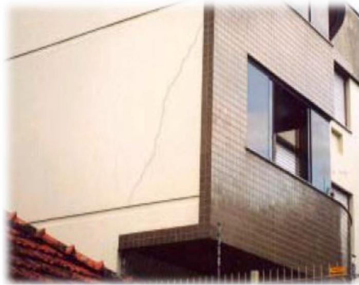
FIGURA 12- Fissura inclinada em alvenaria nos balanços de lajes ou vigas
