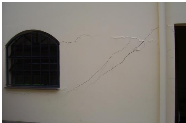
FIGURA 07- Trincas causadas por recalques de pilares
