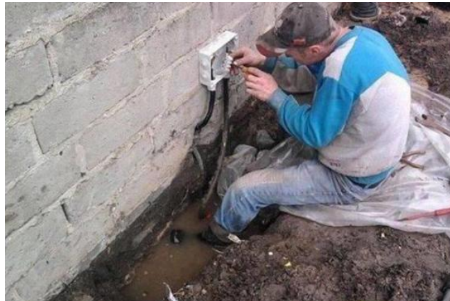
FIGURA 6 – Trabalhador fazendo reparos na rede elétrica sem a utilização de equipamentos de proteção e com os pés dentro da água
