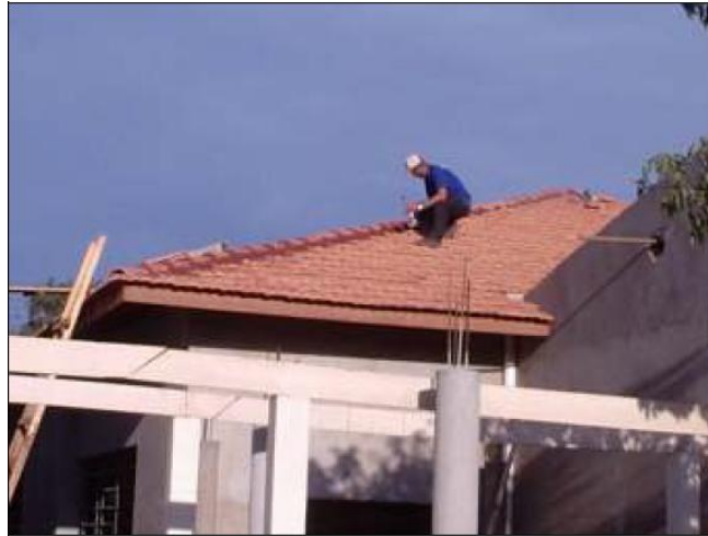
FIGURA 3 – Trabalhador fazendo reparos no telhado sem utilização de equipamento de proteção
