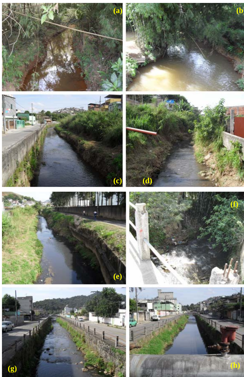
Figura V.6 – Seções do canal do córrego Humaitá trechos: (a) e (b) montante e jusante da entrada do Condomínio Fazenda Ecológicas; (c) e (d) perímetro urbano com edificações densas - ocorre transbordamento no período de chuvas intensas; (e) e (f) montante e jusante da OAC sob a Avenida JK; (g) jusante da OAC sob Ferrovia da RS e (h) montante da OAC sob a Avenida Brasil – capacidade hidráulica insuficiente (registro de transbordamentos).
