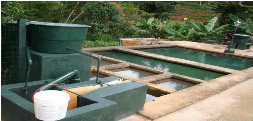
FOTO 11 - ETA- Estação de tratamento de Água do Condomínio Faz.Simão Pereira Fonte: Do Autor (2010)
