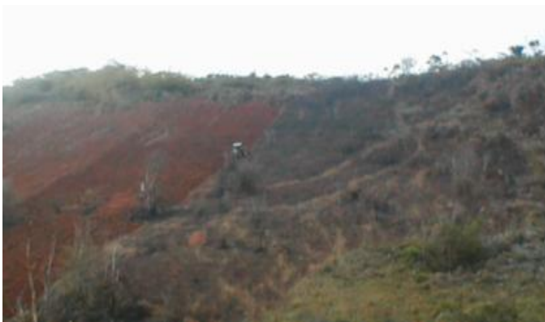
FIGURA 6 – Trator trabalhando em sentido incorreto, retirando a cobertura vegetal.
