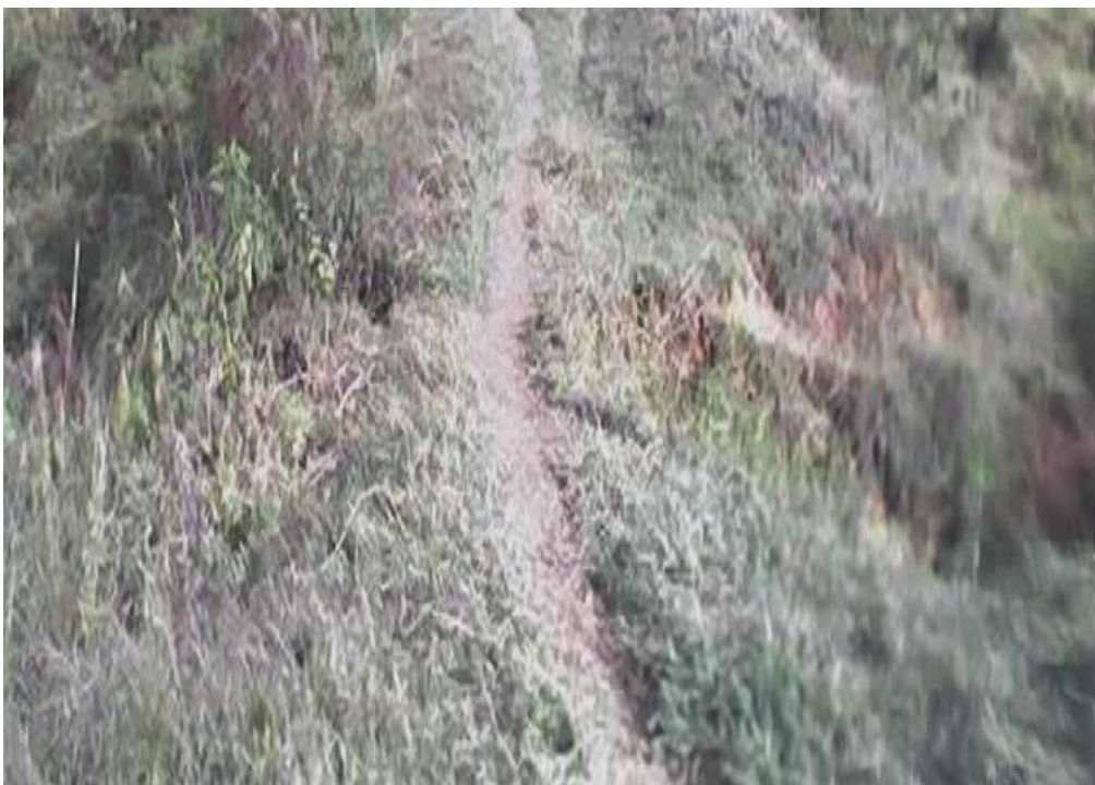
FIGURA 11 – Barragem sobre manilhas sem a devida cobertura vegetativa.
