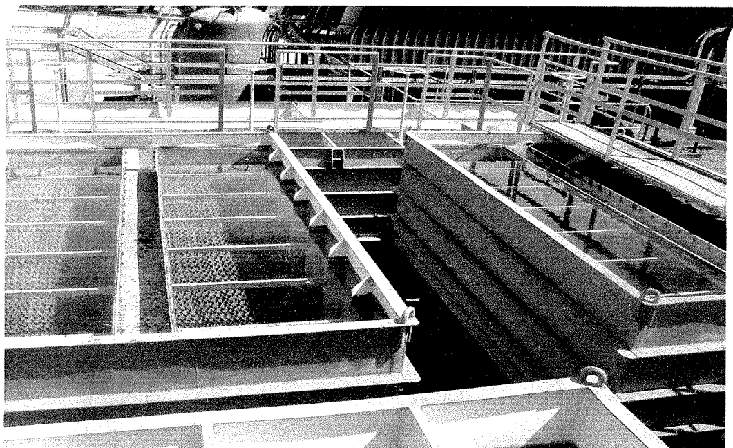
Figura 19: Tanques da ETA da UTEJF.
