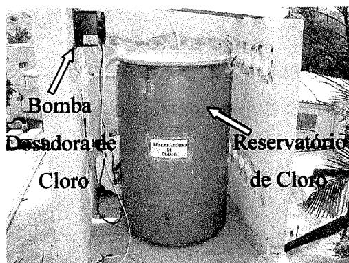
Fig. 08: Bomba dosadora de cloro
