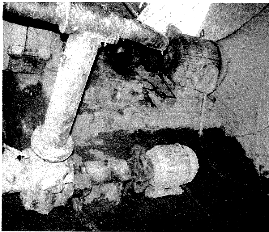
Figura 8- sistema de bombeamento
