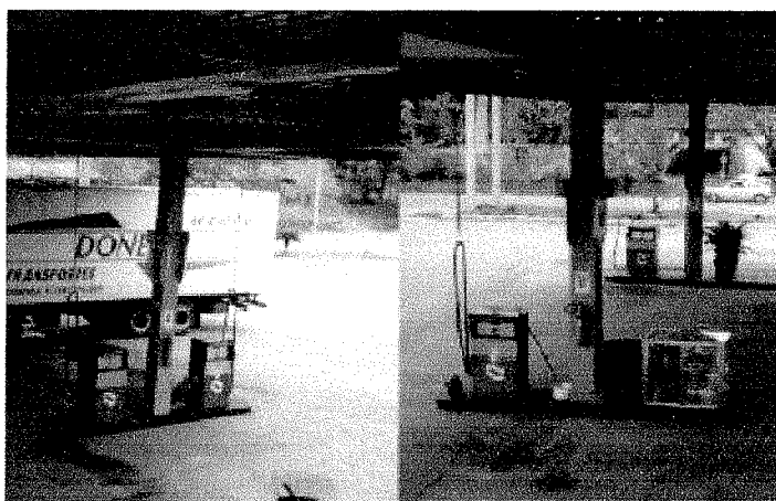
Foto 08 – Foto-montagem das ilhas de abastecimento com destaque para o sistema de extinção de incêndio, com a rodovia MG 061 ao fundo.
