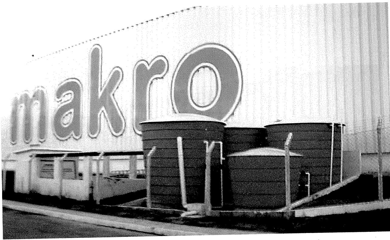
Figura 10 – Foto da Estação de Tratamento de Efluentes MAKRO
