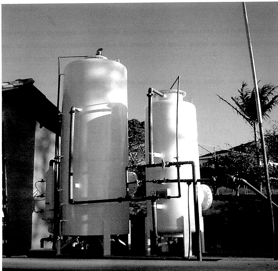
Figura 16 – Foto da estação de Tratamento de Água Laticínio 5 estrelas
