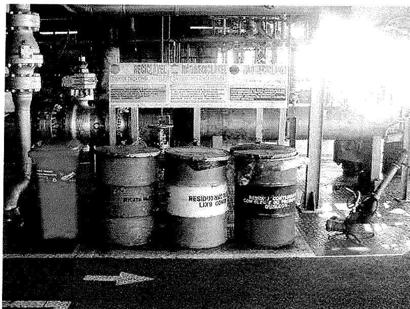
Figura 9- Coletor Tilimpa, tambores de sucata metálica, lixo comum, resíduo oleoso.
