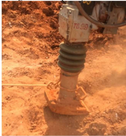
Figura 1. Compactação do solo
