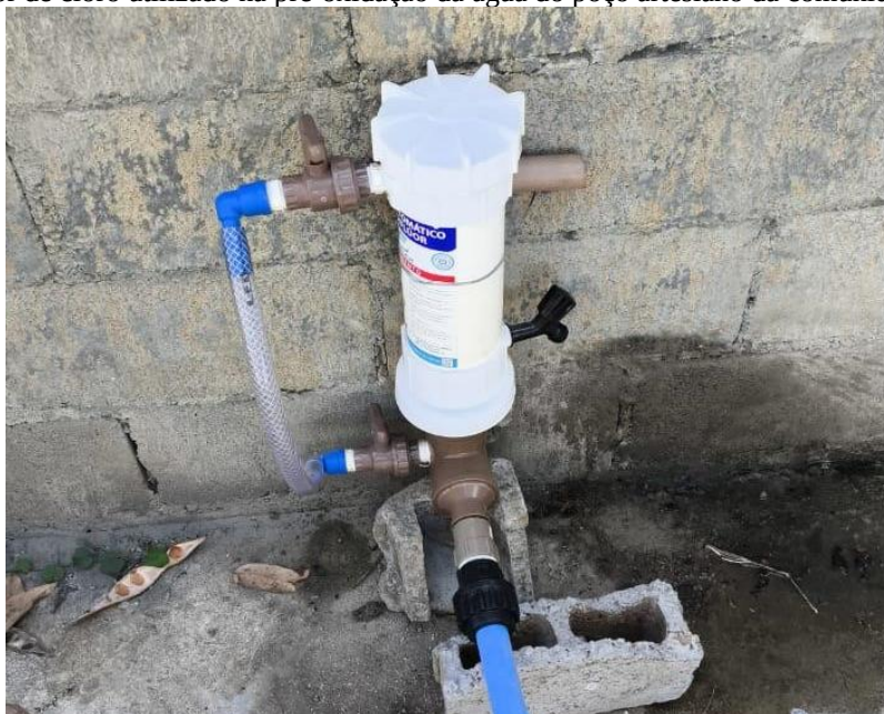
Figura 1 – Dosador de cloro utilizado na pré-oxidação da água do poço artesiano da comunidade Santa Helena
