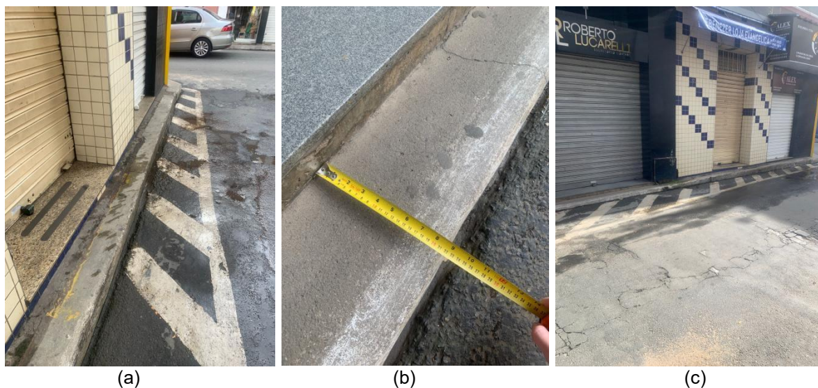
Figura 14 – Calçadas dos imóveis próximos à esquina com a Rua Quinze de Novembro
