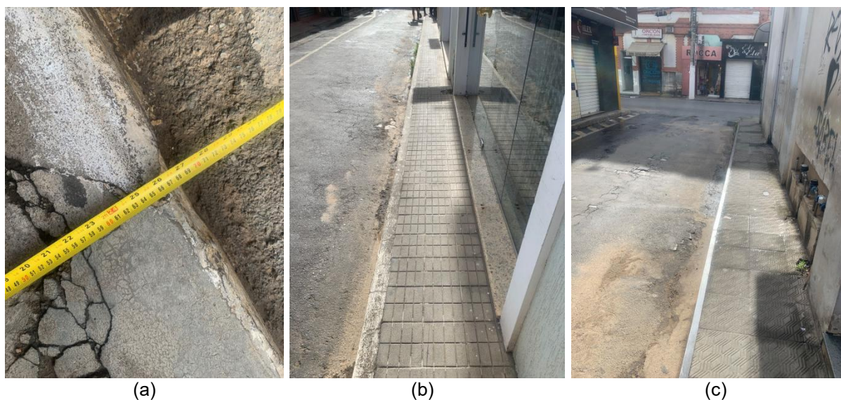
Figura 16 – Calçada contínua com medida inadequada
