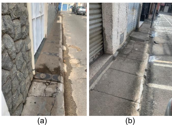
Figura 17 – Calçada sem manutenção
