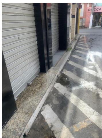
Figura 15 – Calçada com medida inadequada e piso liso
