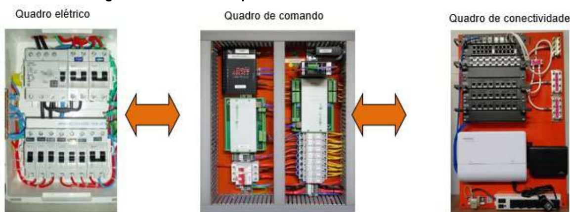
Figura 4 - Quadros componentes do shaft de conectividade
