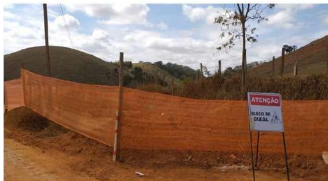
Figura 3 - Barreira de terra com sinalização de caixa
